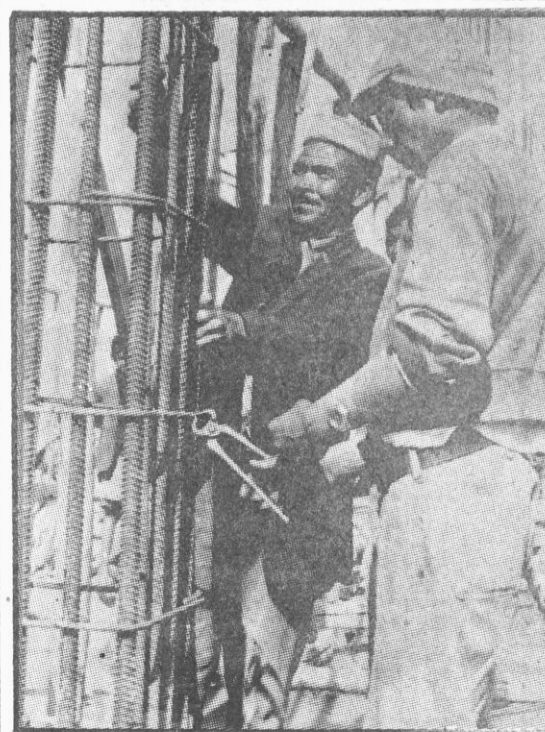
مردم زحمتکش کشور ما همزمان با دفاع جان نوازانه از دست آورد های انقلاب تلاش بغا طر سا زندگی را نیز ادامه میدهند. رحیم داد و سخنی داد کارگران دستگاه ساختن بنایی هنگام کار در یکی از ساختمان های جدید.
