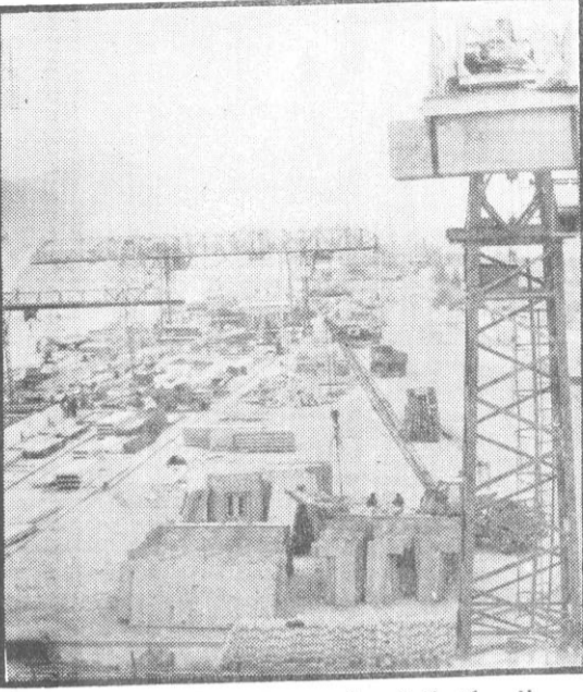
فابریکه خانه سازی بهشتا به بیگانگان مجبزی در دست کارگران بخش ساختمانی در کار اعمار منازل مدرن برای هموطنان ما تسهیلات عظیمی را میسر ساخته است. در عکس نمای از این فابریکه را مشاهده میکنید.
