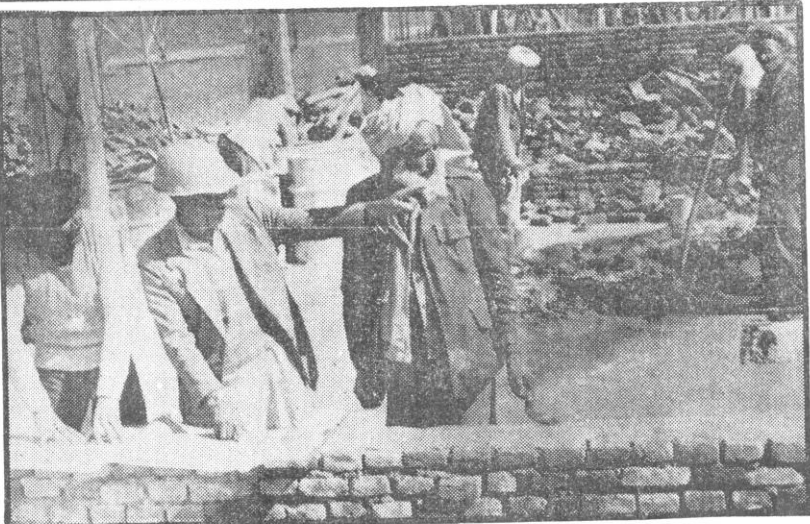
کارگران و انجیران ریاست کار و ساختمان شاری کابل در حال اعمار و کسپ ترمیم و سایش آن ریاست.
