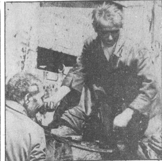
کار خلاق و سازنده کارگران در راه تحکیم پایه های اقتصادی انقلاب نقش عظیمی دارد. عکس کارگران ریاست میخانیک وزارت فوآند عامه را هنگام اجرای کار نشان میدهد. (عکاسی ج.ا.ش)
