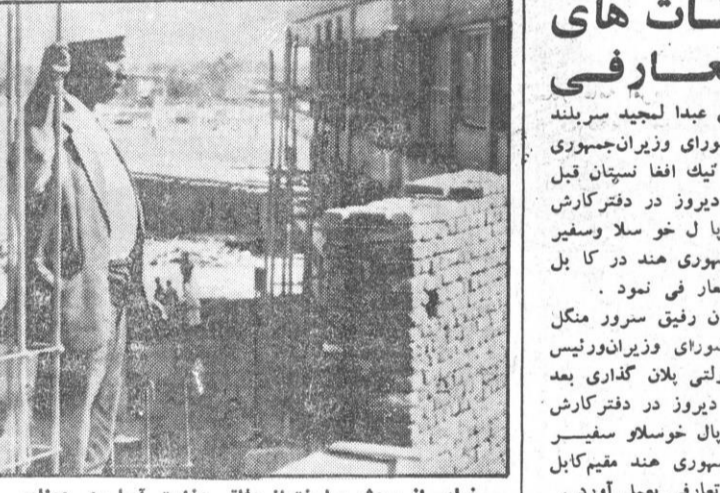
نمایی از پروژه ساختمانی دفتر وزارت آب و منابع آب که در ساحه دارلما در حال اعمار است. این پروژه در ساحت مساحت هزار متر مربع زمین اعمار گردیده و دارای چهار بلاک می باشد. عکاسی: ح. ا. ت.
