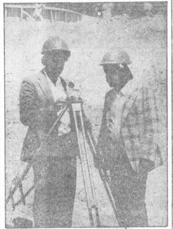
استفاده از میتود ها و شیوه های علمی انجیری، در عرصه اعمار ساختمانها به جزء لاینفک امور ساختمان های عصری مبدل گردیده است امروز در کشور ما که ساختن بناهای عصری روز تاز روز توسعه می یابند، این شیوه ها توسط انجیران جوان بخش ساختمانی در عمل پیاده میگردد. در عکس انجیران عیبه لصبور و انجیر عزیزالله دو تن از انجیران دستگاه ساختمانی سپین غر که در مسابقات کار سیم شایسته داشته اند با بکار برد یکی از آلات ساختمانی مصروف کار مقاماتی ساختمانی میباشند. عکاسی هاشم ندیر
